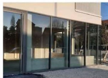
Muret anti-crue derrière une vitrine commerciale à Grenoble © Actis / FLOO architecture
