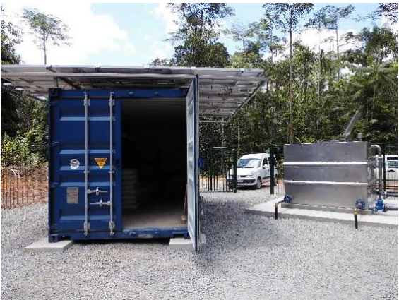
Figure 12: Unité de potabilisation de Favard
